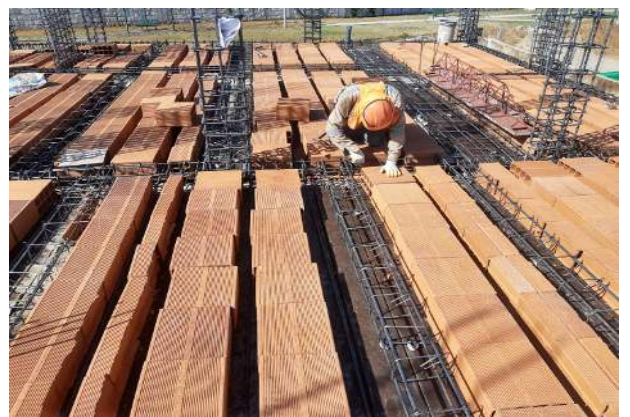
ALINEAMIENTO DE LADRILLO
