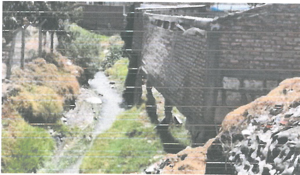
Deterioro de muros colindantes con la torrentera
