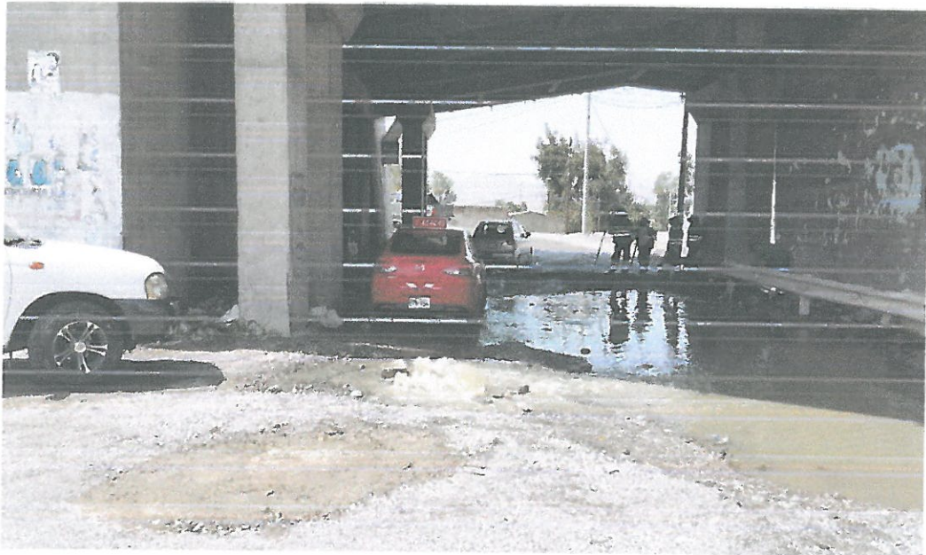
Colapso en drenajes, Puente San Isidro
