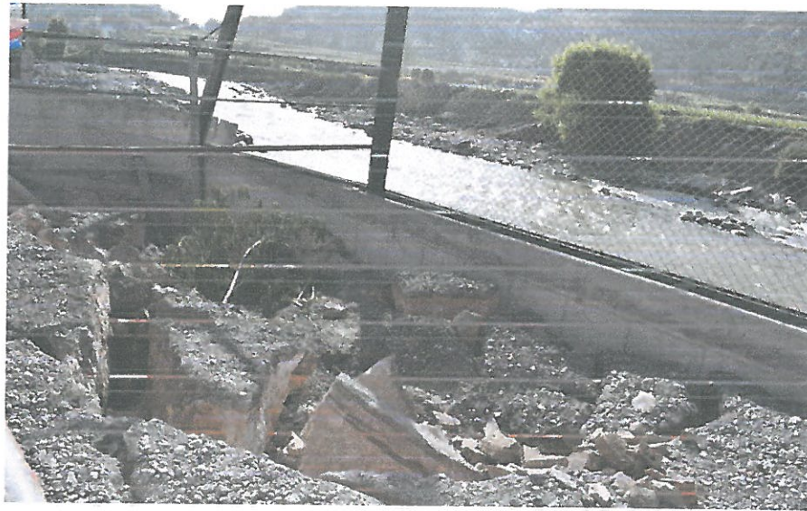
Caída de Muro en Av. Arancota
